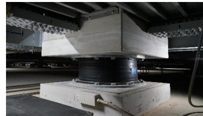
免震装置「積層ゴム支承」
