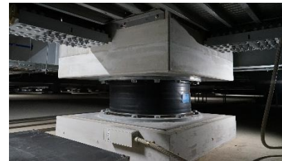
免震装置「積層ゴム支承」
