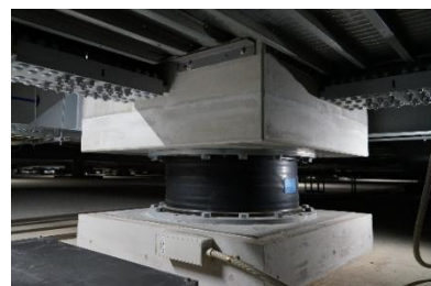
免震装置「積層ゴム支承」
