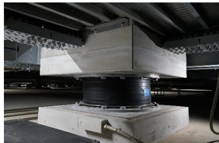
「プラネット愛知」導入の免震装置
