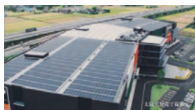
ブラネット埼玉屋上の太陽光発電パネル
