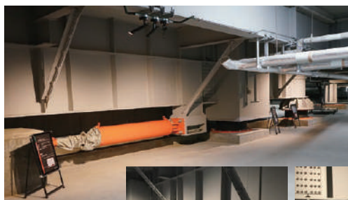
プラネット埼玉の 免震装置
