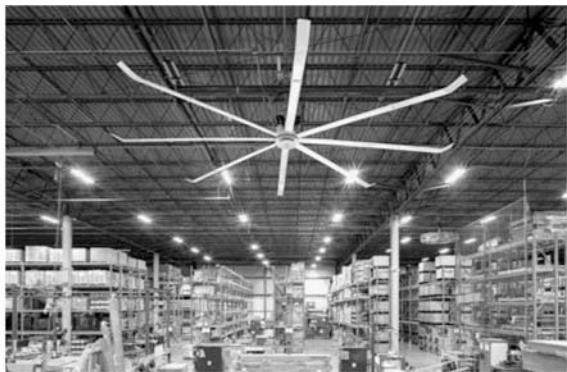
豊田通商の超大型HVL Sシーリングファン「ビッグアスファン」
